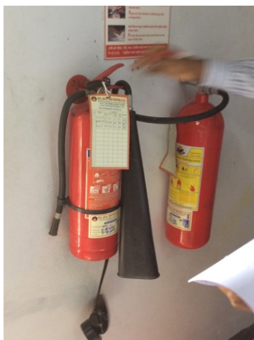
CO2 portable fire extinguisher
