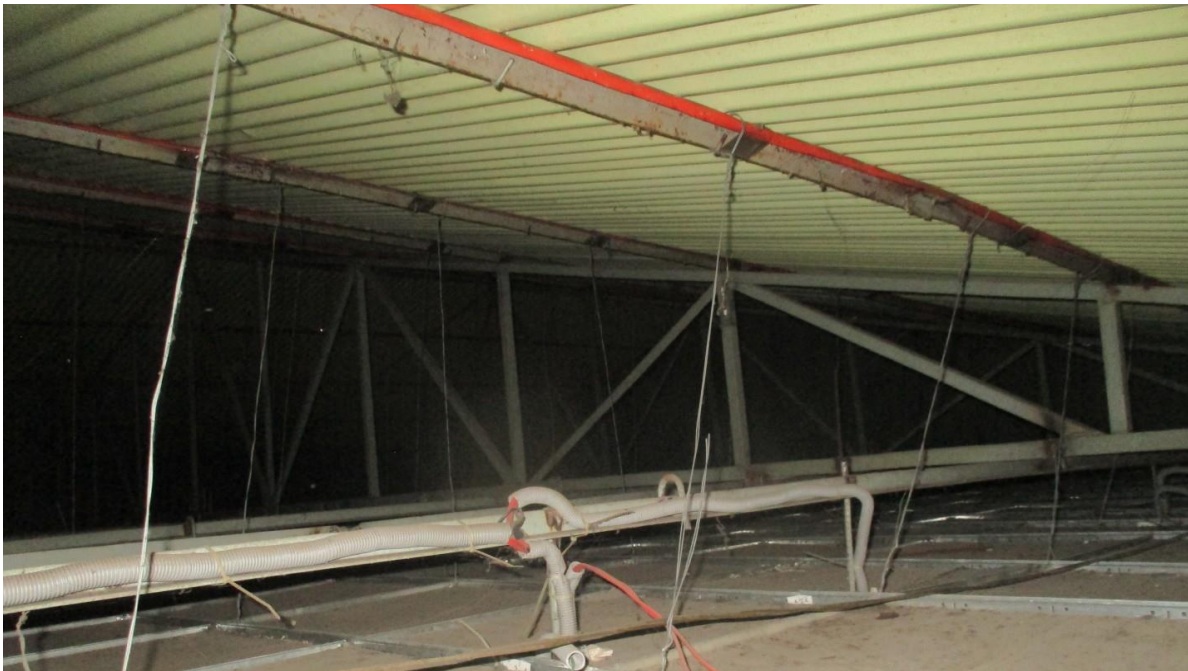
Actual Truss Section (No roof bracing)
